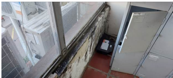
Foto 88: peitoril janela com infiltrações
