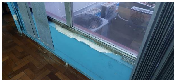
Foto 173: infiltração e descascamentos
