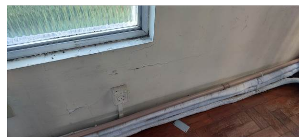
Foto 85: trincas no peitoril
