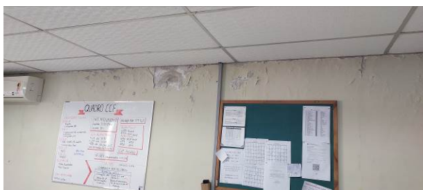
Foto 48: desagregamento e descascamento
