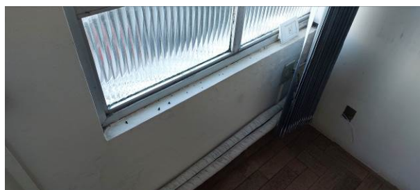
Foto 80: peitoril sala 4 - infiltrações
