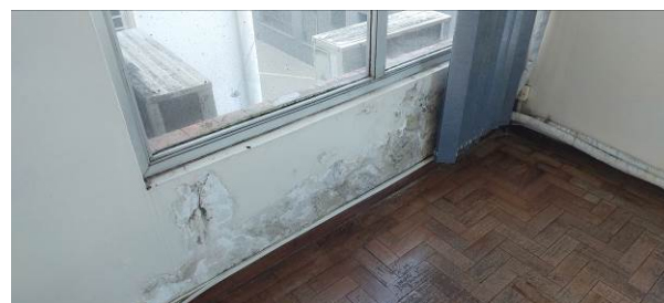
Foto 81: peitoril sala 5 - infiltrações
