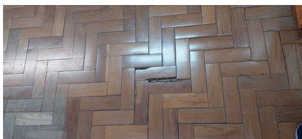
Foto 49: tacos soltos e com falhas
