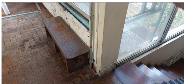
Foto 84: infiltrações peitoril e escadas
