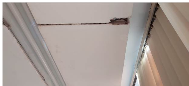
Foto 111: dilatação forro gesso
