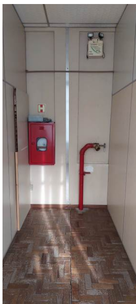
Foto 316: hidrante 3º Pavimento
