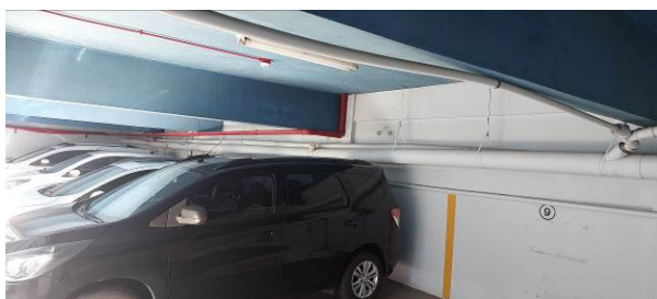
Foto 314: tubulações pelo forro Garagem
