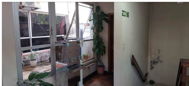
Foto 218: infiltrações peitoril e escada
