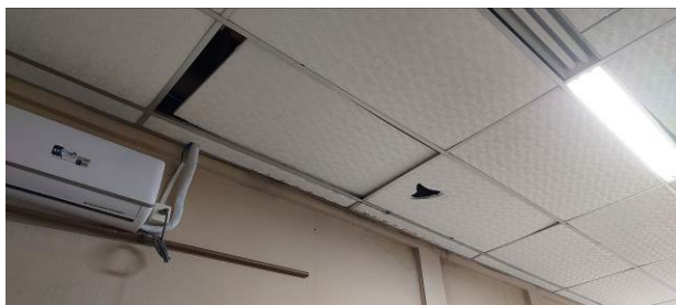
Foto 11: infiltrações parede e forro
