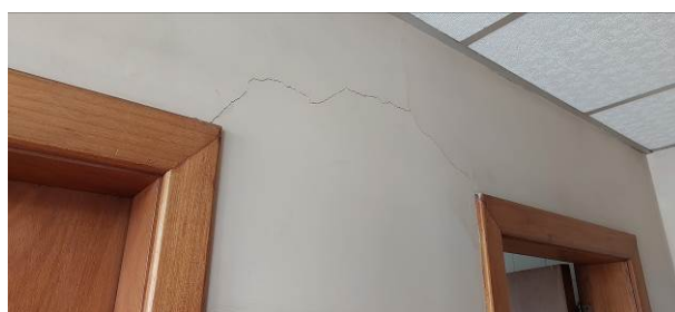
Foto 61: rachadura entre portas
