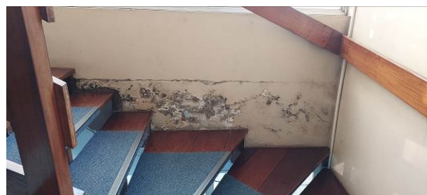
Foto 282: infiltrações e rachadura
