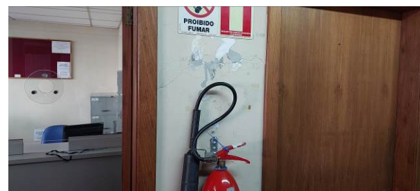
Foto 214: rachadura entre portas
