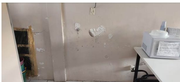
Foto 5: desagregamentos e rachadura
