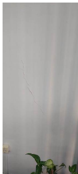
Foto 135: Diretoria Fissura parede
