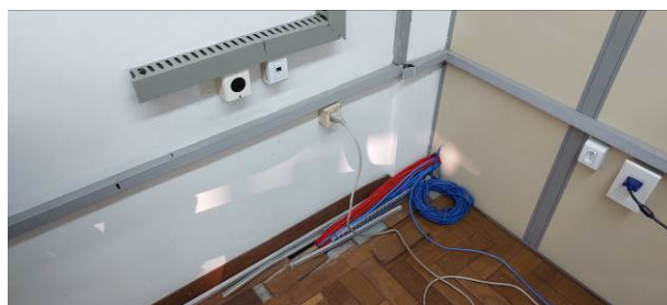
Foto 39: elétrica aparentes e tacos soltos
