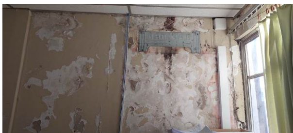
Foto 123: desagregamento e descascamento
