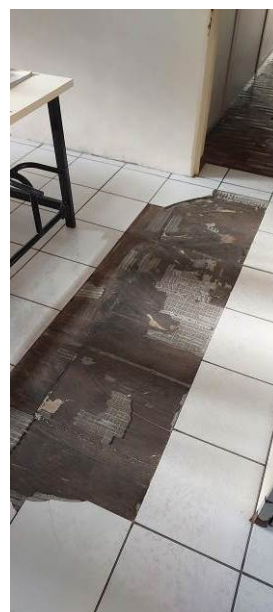
Foto 6: piso faltando e quebrados
