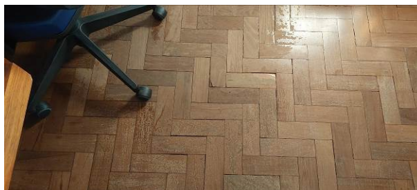
Foto 124: tacos desgastados e soltos
