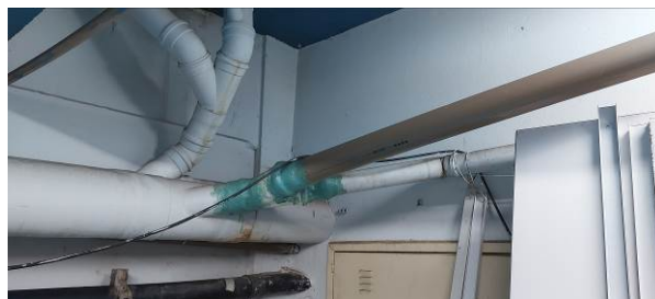
Foto 315: tubulações no Depósito
