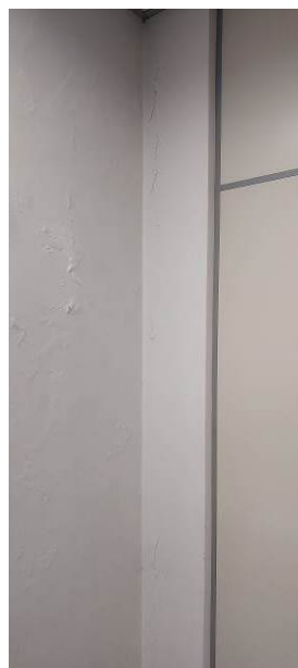
Foto 69: desagregamento e fissura
