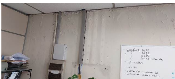
Foto 52: desagregamento e descascamento
