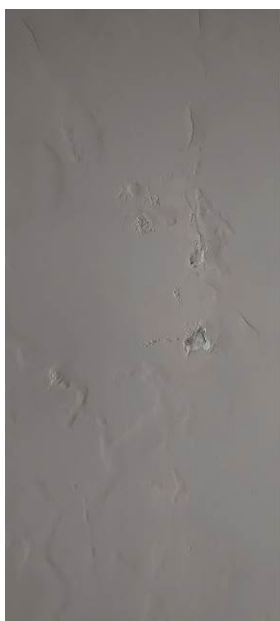
Foto 68: desagregamento e descascamento
