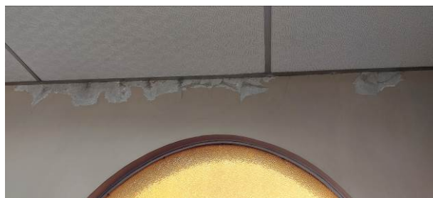
Foto 148: infiltração e descascamentos
