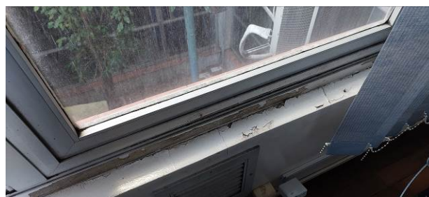
Foto 169: infiltração janela e descascamento
