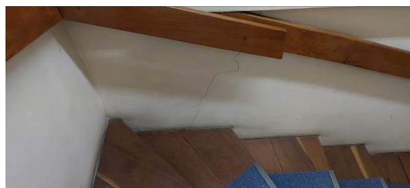
Foto 275: rachadura na parede
