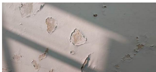
Foto 37: desagregamento e descascamento
