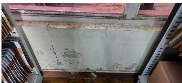
Foto 209: infiltrações e desagregamentos
