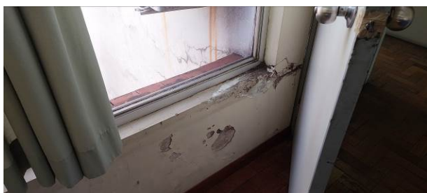
Foto 42: desagregamento e descascamento
