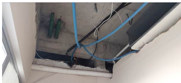
Foto 89: trecho sem forro
